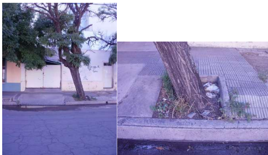
11-D-M1 (a) y (b). Ejemplar de Acacia bola ( Robinia pseudoacacia var umbraculifera ) inclinado. Riesgo de caída total.
