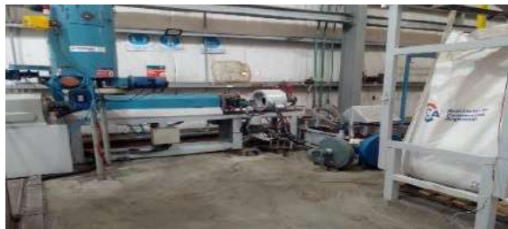
Ilustración 18: Recuperadora zona de extrusión.
