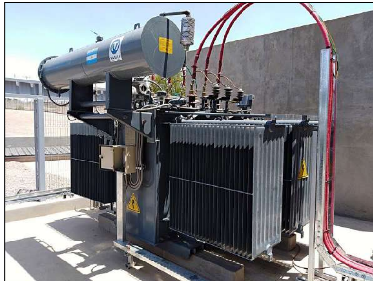
Imagen N° 2: Transformador de distribución. Reproducido de "Vasile", 2024 ( http://vasile.com.ar ). Todos los derechos reservados 2024 por Licenciatario. Reproducido con permiso de la empresa (ANEXO N°17).
