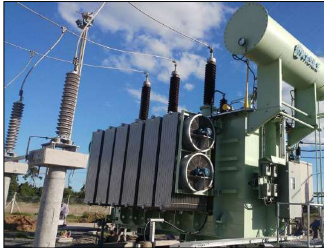
Imagen N° 1: Transformador de potencia. Reproducido de "Vasile", 2024 ( http://vasile.com.ar ). Todos los derechos reservados 2024 por Licenciatario. Reproducido con permiso de la empresa (ANEXO N°17).
