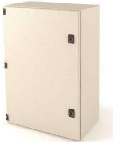
Imagen 53: Tablero seccional general
