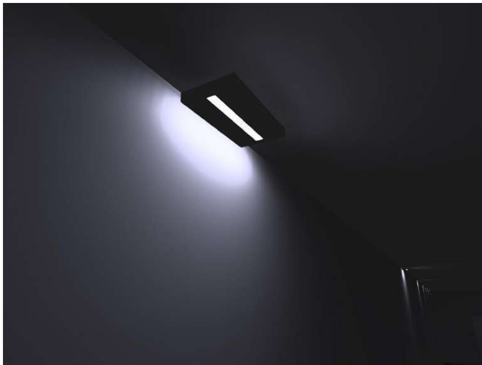
Imagen 2: Detalle luces de emergencias instaladas
