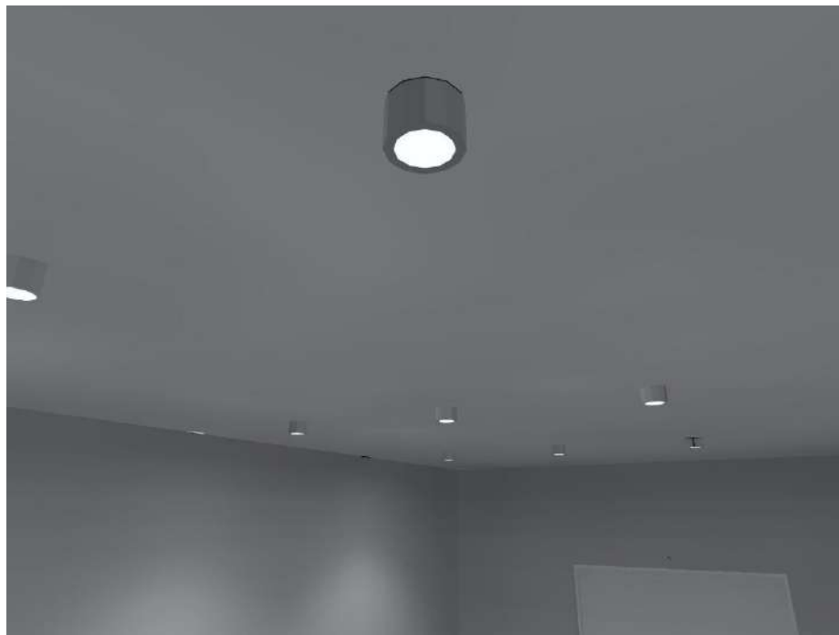
Imagen 6: Detalle luminarias NVC - NWP619N-L 100W instaladas
