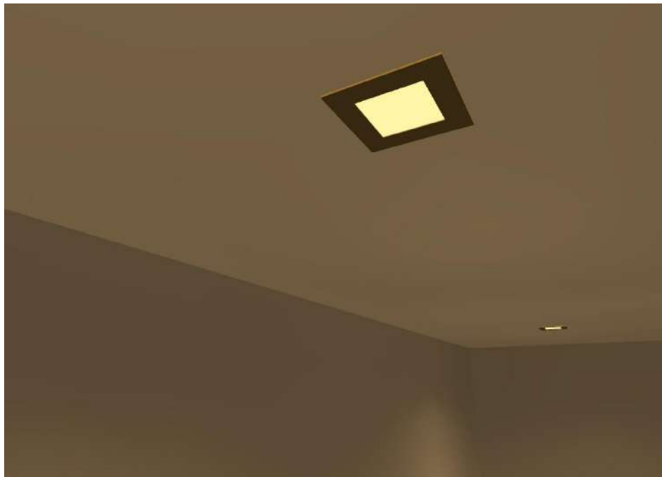
Imagen 4: Detalle luminarias LEDS-C4 instaladas
