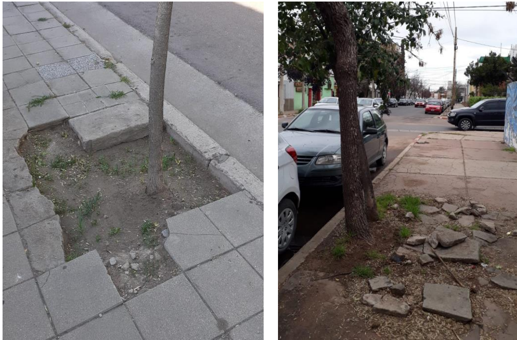
Figura 14: Veredas en mala condición con roturas y con deterioro evidente.
