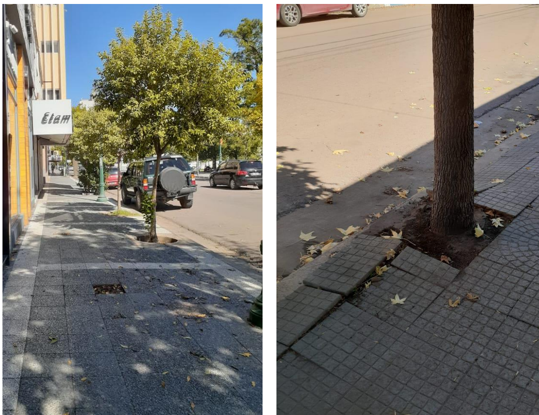
Figura 41. Condición de la vereda: Veredas en mala condición en la zona céntrica de la ciudad de Santa Rosa, La Pampa.
