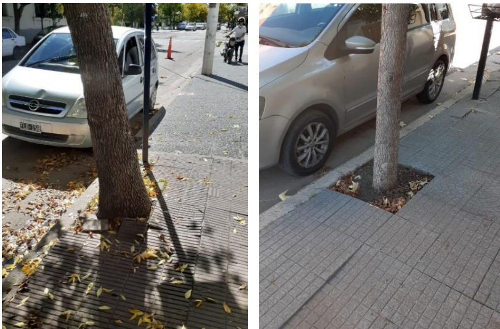
Figura 15: Veredas en condición regular con baldosas levantadas y desniveladas.
