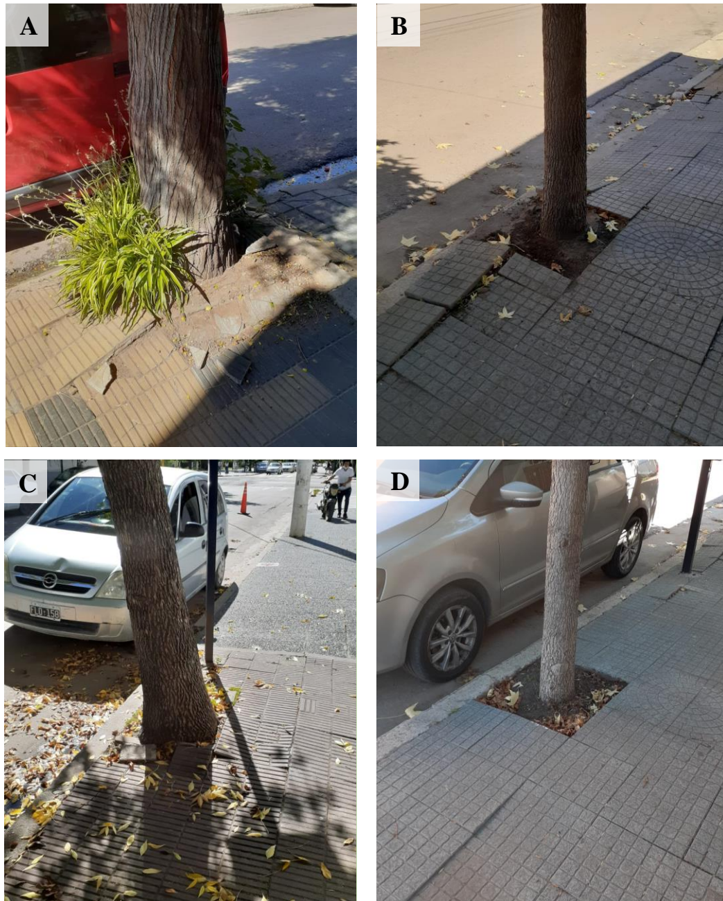
Figura 42. Evidencia de raíces: Alta (A y B) y baja (C y D) en el AUA la zona céntrica de la ciudad de Santa Rosa, La Pampa.
