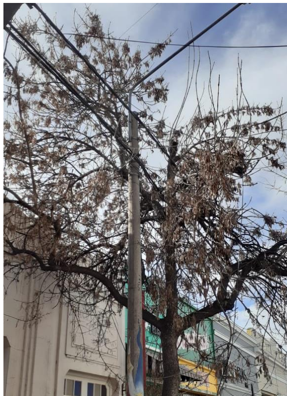
Figura 45. Interferencias del arbolado: Ejemplar con ramas enredadas en el cableado.
