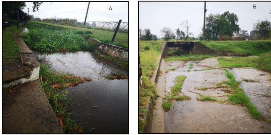
Figura 7. Canales a cielo abierto que recolectan, para transportar a la Laguna Don Tomás, excesos de precipitación que no logran ser captados por Sistema Menor. Canal ubicado en el final de calle Sarmiento (A) y en el final de la Avenida San Martín Oeste (B).
