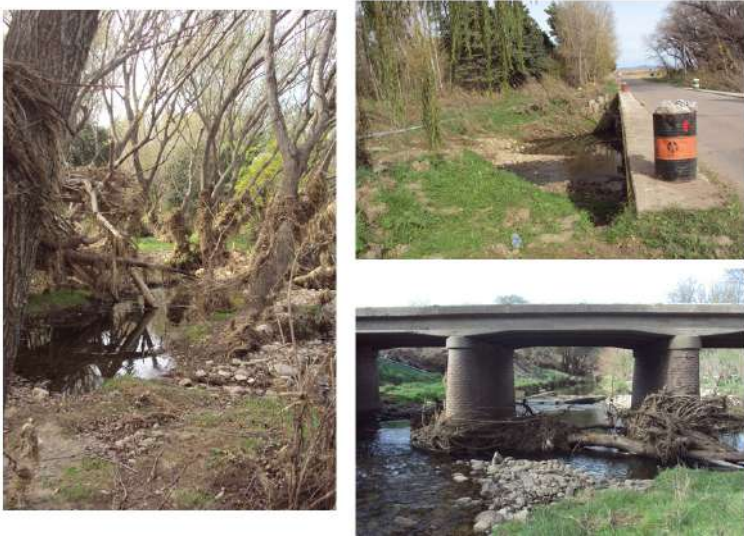
Figura N° 6. Daños ocasionados por la crecida (17/03/2015)
