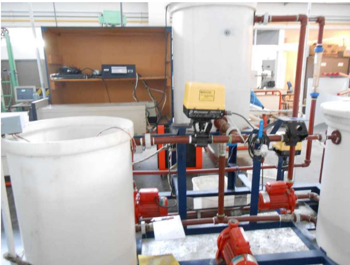
Figura 13: Fotografía frontal de la Planta hidráulica.
