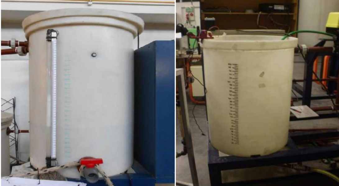
Figura 3: Fotografías de tanque reservorio (izquierda) y tanque principal (derecha).
