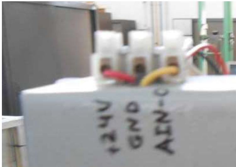
Figura 25: Bornera de conexiones del sensor.
