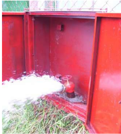
Fig. 24: Boca de impulsión resguardada en un nicho accesible por los bomberos.
