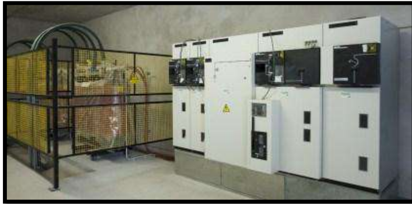
Fig. 40: Subestación en un interior.
