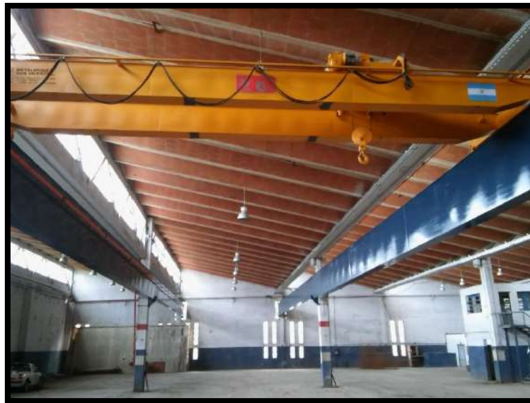
Fig.3: Puente grúa del sector depósito de producto terminado.
