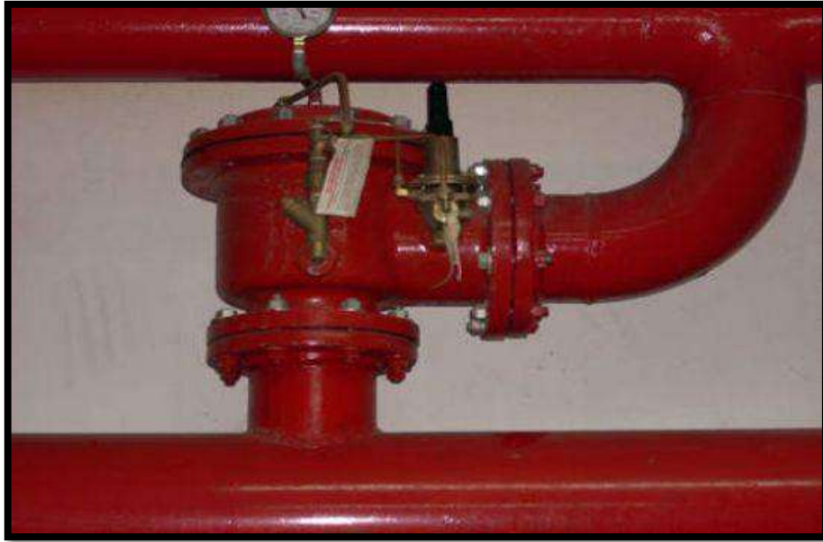
Fig.14: Cañería para sistema de hidrantes.
