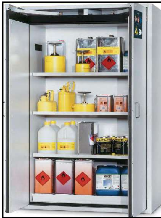
Figura 14. Depósito de sustancias peligrosas.
