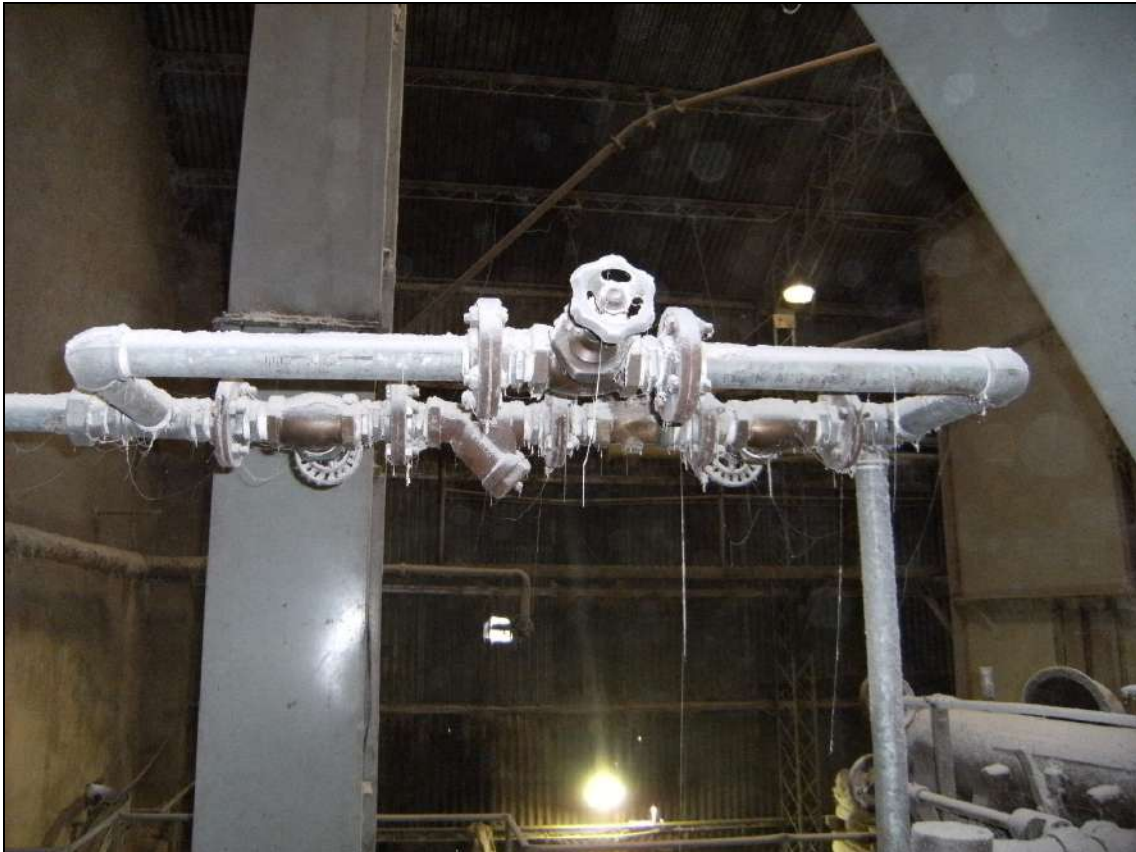
Figura 7: Cuadro de vapor existente.
