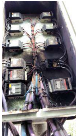
Figura 1: Tablero de chapa de BT Zona 142.
