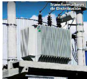
Figura 5: Transformador de distribución
