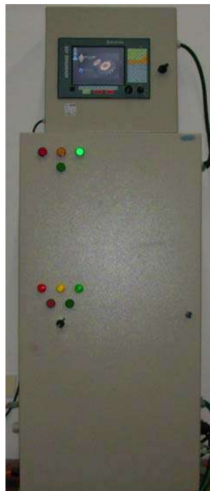
Figura 4-2: Gabinetes donde se aloja el sistema de control
