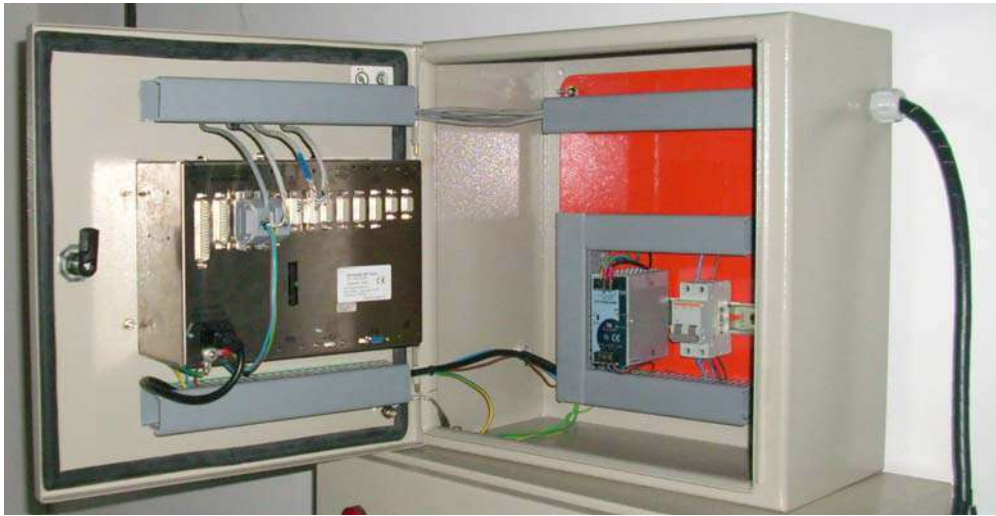
FIGURA 4-3 : Gabinete menor que aloja al controlador Advantage 400
