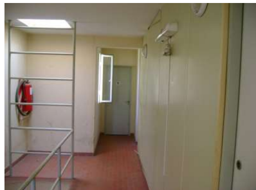
- Sensor ubicado en la Caja de Escalera
