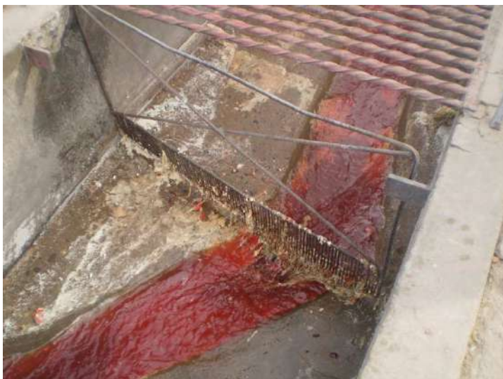
Fotografía 3. Rejas. Dispositivo para separar sólidos gruesos, donde estos se acumulan y se deja escurrir el resto del agua.
