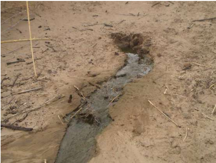
Fotografía 11. Se puede observar la filtración de la segunda pileta de oxidación.
