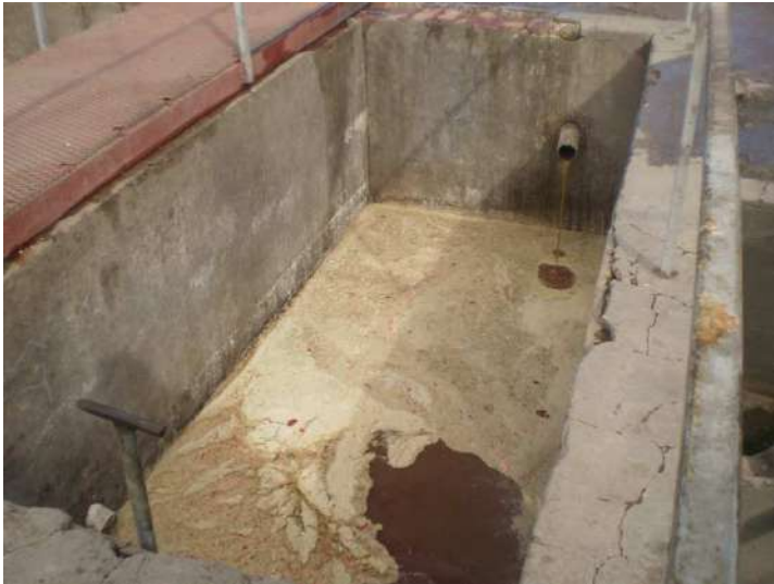
Fotografía 4. Pileta de decantación.
