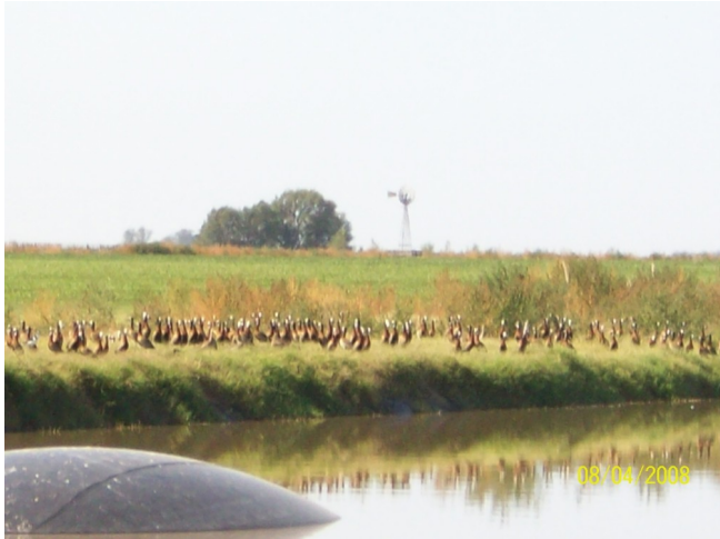
Fotografía 1: Presencia de numerosas aves en borde de pileta facultativa N° 1, se puede observar una parte del globo de gas de la misma.
