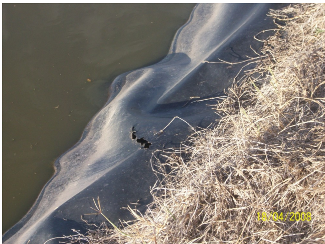
Fotografía 5: Membrana impermeabilizante rota aparentemente por roedores.
