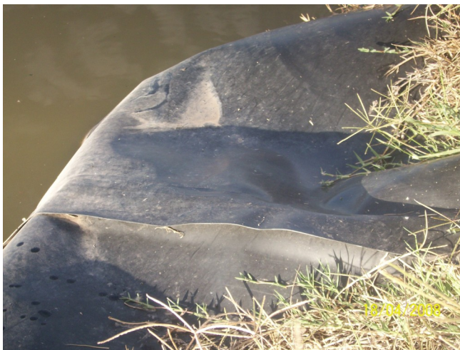
Fotografía 7: Membrana impermeabilizante rota.
