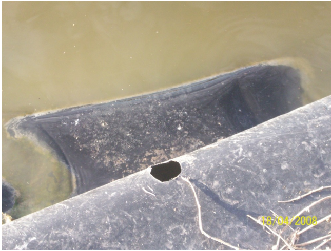
Fotografía 6: Membrana impermeabilizante rota.
