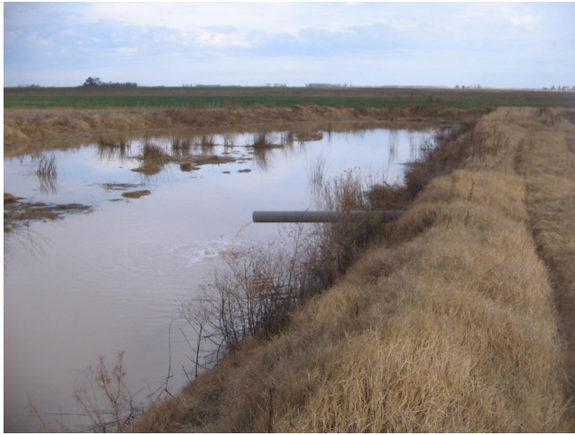
Fotografía 15: Detalle del estado del canal que colecta el líquido tratado de ambas piletas y las dirige hacia su deposición final (presencia de pastos). Se observa salida de líquido tratado desde la pileta N° 1
