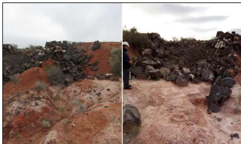
Figura 6.27. Desmoronamiento de la defensa de basalto y erosión hídrica activa.
