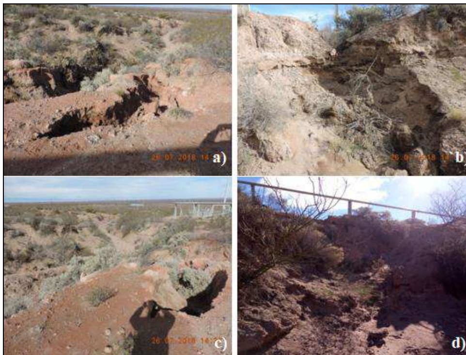
Figura 6.12. a) Vista general del carcavamiento al Este de la Batería, b) Cárcava lateral en el plumín de venteo, c) vista general de la cárcava en la zona del plumín y d) cárcava que afecta la base del plumín de venteo.
