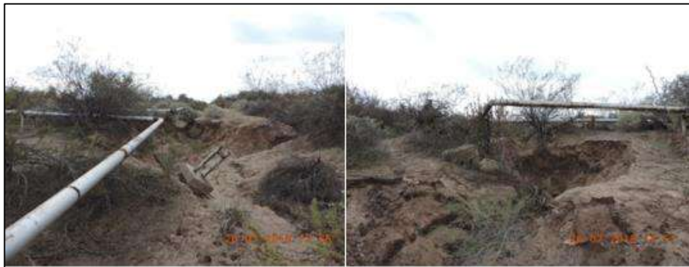
Figura 6.16. Bases de hormigón descalzadas de la línea de inyección.
