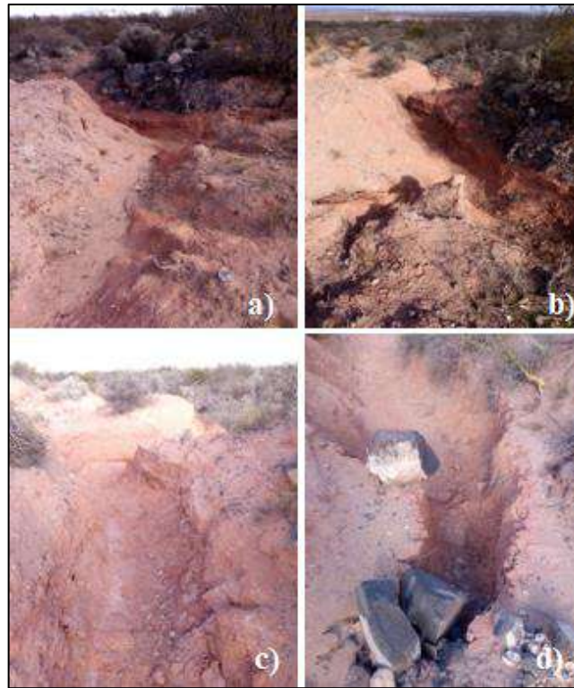
Figura 6.11. a) y b) Roturas del actual enrocado en sus laterales, c y d) erosión retrocedente activa y arrastre del material del enrocado.
