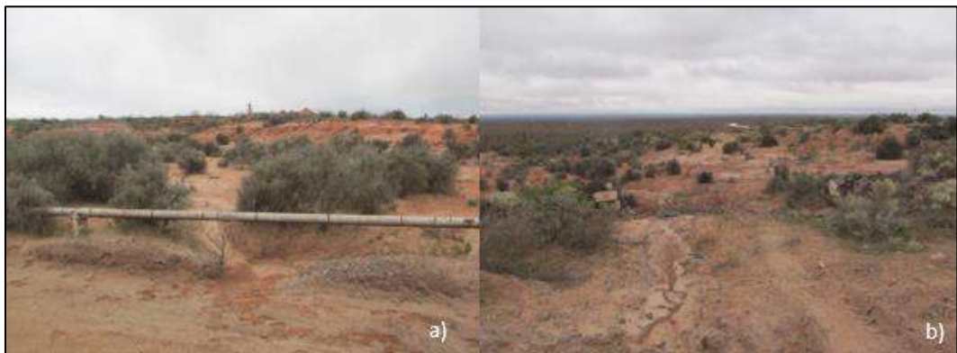
Figura 6.38. a) Ruptura de berma en el camino en el lateral Norte. b) surcos en el lado Sur del camino a nivel de la cabecera de cárcava N° 3 en continuación con el drenaje de la imagen a).
