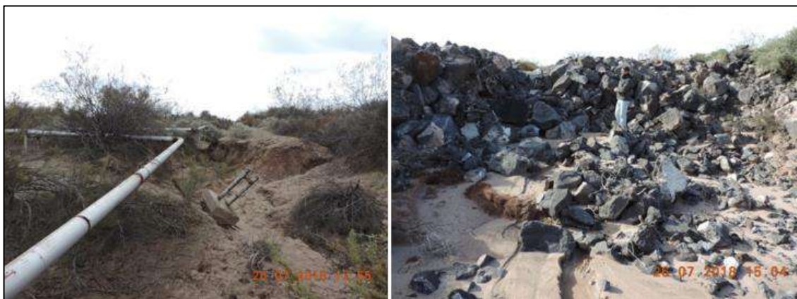
Figura 6.1. En la imagen de la izquierda se observa el descalce de la base de hormigón que soporta línea de inyección, y en la derecha se demuestra el debilitamiento de las defensas de enrocado.
