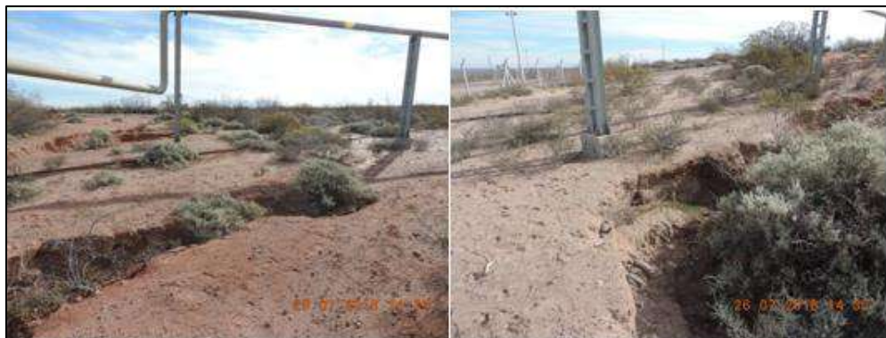
Figura 6.14. Riesgo en los cimientos de los soportes del plumín.
