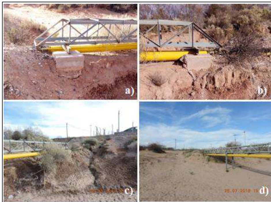
Figura 6.19: a y b) Fotos con detalle del descalce de los cimientos del puente ducto en ambos laterales c) y d) Imagen panorámica de ambos descalces.
