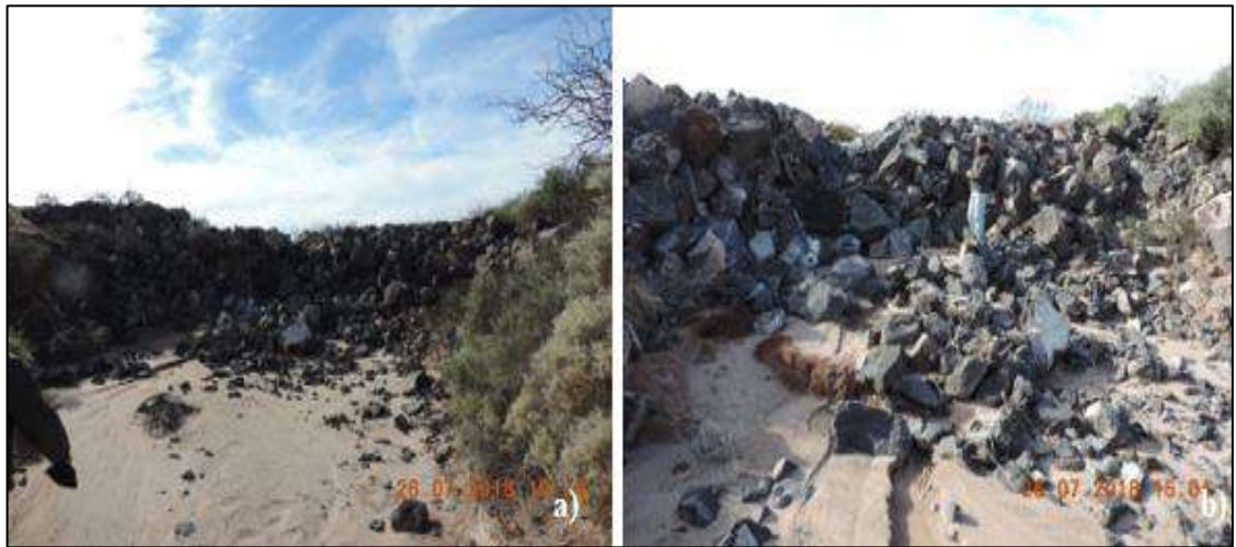
Figura 6.23. a y b) Defensa de basalto en cárcava N° 2 con presencia de desmoronamiento.
