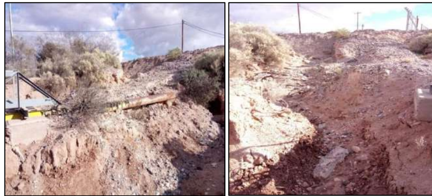
Figura 6.20. Cárcavas y destape de gasoducto.
