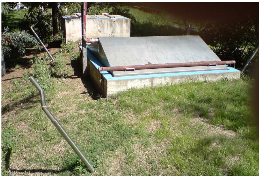
Figura 2. Vista en primer plano de la parte superior de la cámara de digestión. También se aprecian las manijas de agitación manual y al fondo la cámara de descarga.
