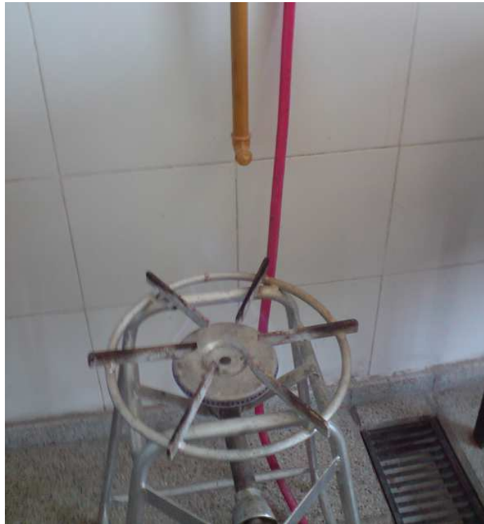
Figura 13: Mechero encendido a base de biogás.
