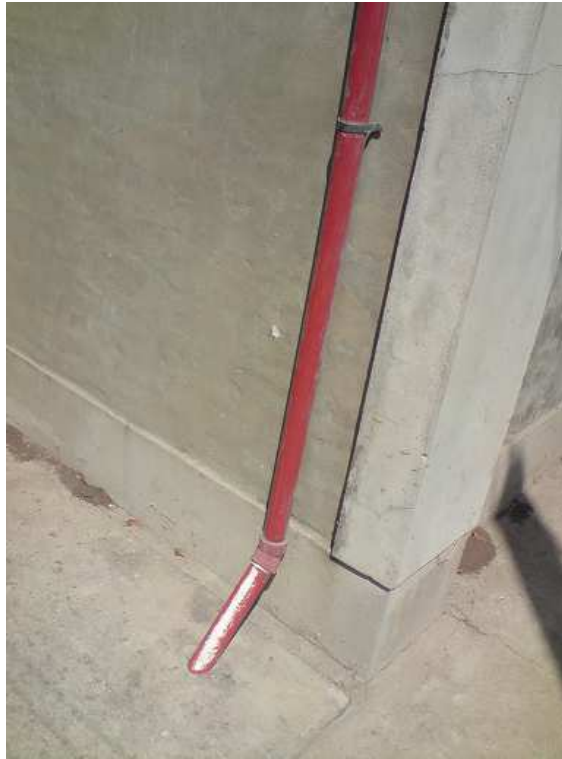
Figura 9: Caño de salida de biogas desde la cámara de unión hacia la cocina.
