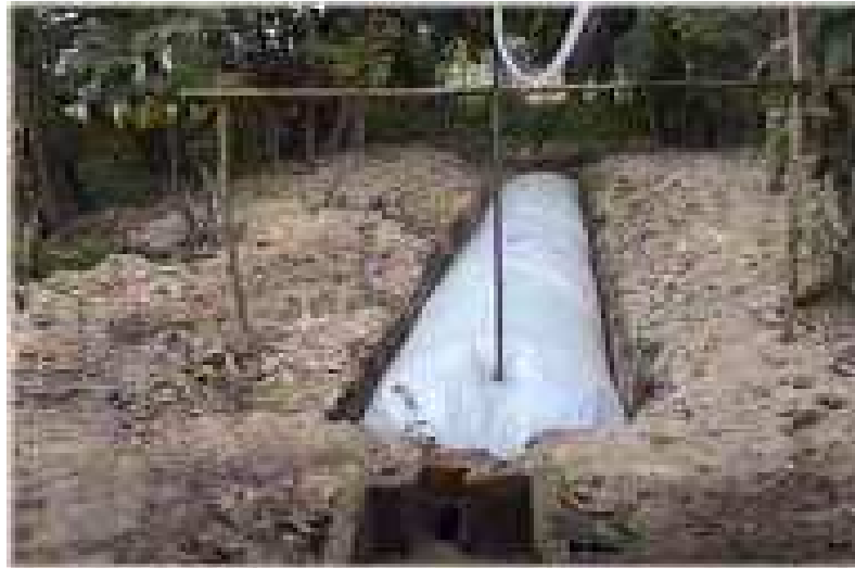
Biodigestor flexible (polietileno). Fuente: Fundación Hábitat.
