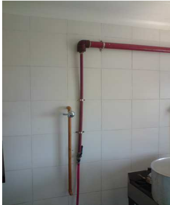
Figura 11: Caño de bajada del biogás hacia el mechero.
