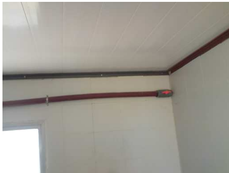
Figura 10: Caño de entrada de biogas a la cocina.
