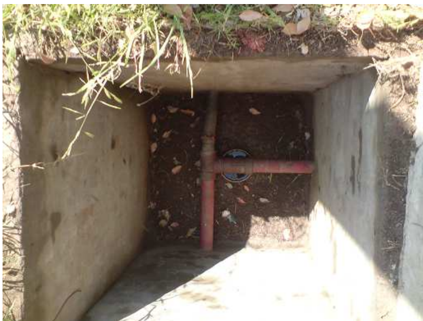
Figura 8: Cámara que une el caño que trae biogás del biodigestor, el caño que va al gasómetro y el caño de salida de biogás hacia la cocina.
