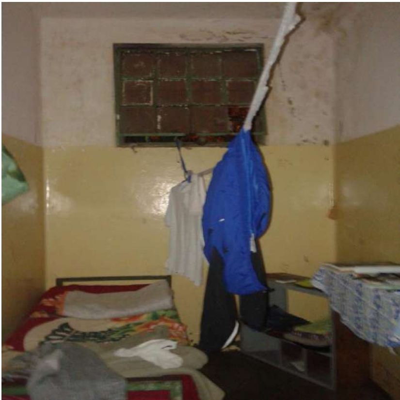
Infraestructura en mal estado.
