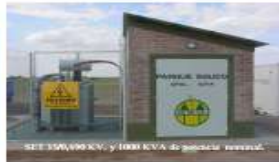
SET 33/0,69 KV. y 1000 KVA de potencia transform.
